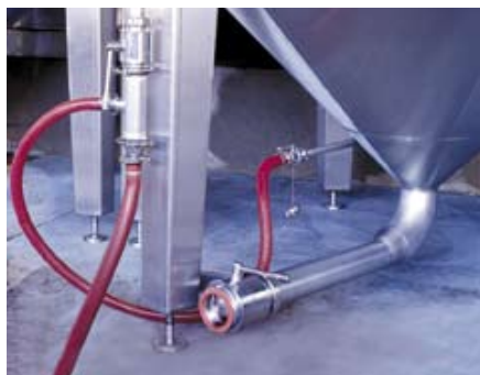
Fondo Conico con dispositivo "Sluice Point"
